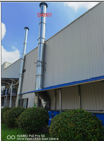
15 米高排气筒 DA001
