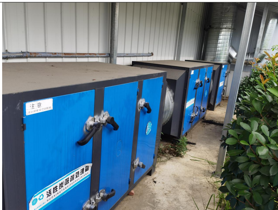
干式过滤器+二级活性炭吸附装置
