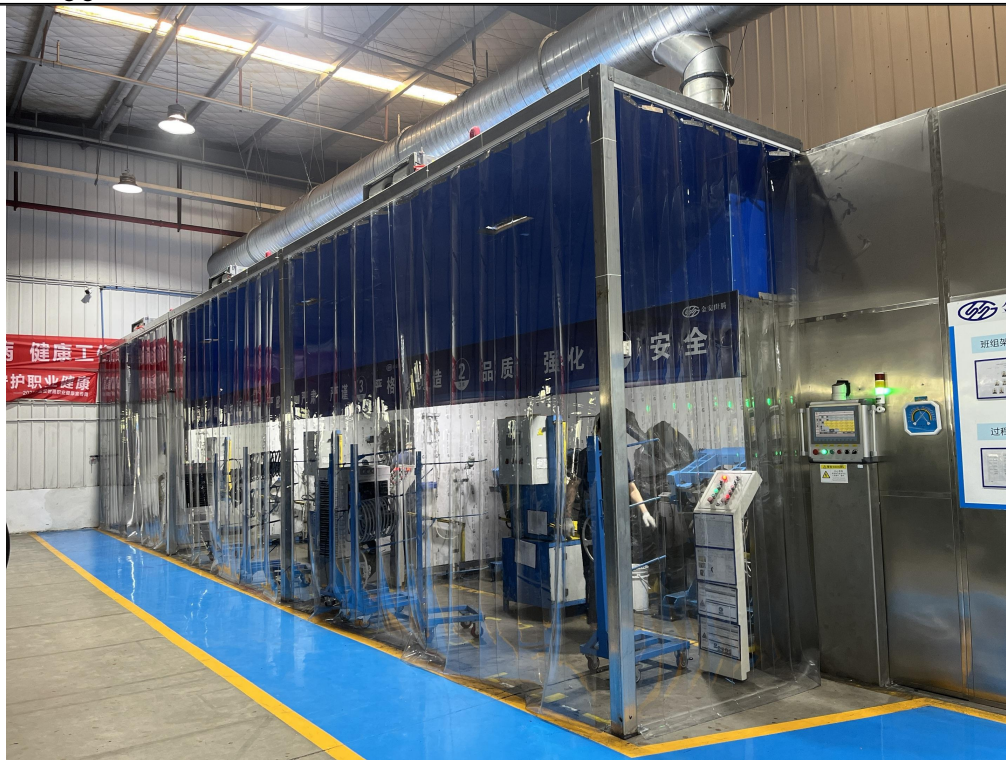
发泡工位集气罩+密闭隔间
